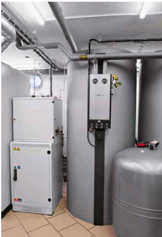
Abb. 5: PEM-Elektrolyseur (l. im Unterschrank) und einer von drei 1.000-L-Warmwasserspeichern (M.)
