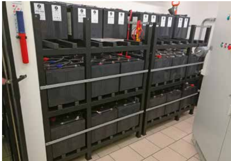
Abb. 4: ... und Akkumulatoren auf der anderen Seite der Wand
